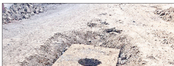
सोनीपत। प्रगति नगर एक्सटेंशन में खुले सीवर के मेहोले।
